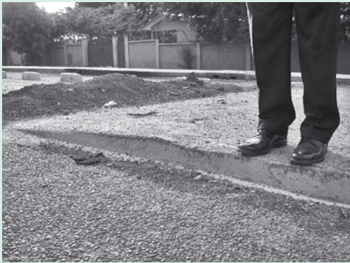
مقطع عرضي للمنطقة الإسمنتية المرفوعة، 10 سم ارتفاع، 1 م طول المنحدر، السرعة المطلوبة 30 كم/ساعة
